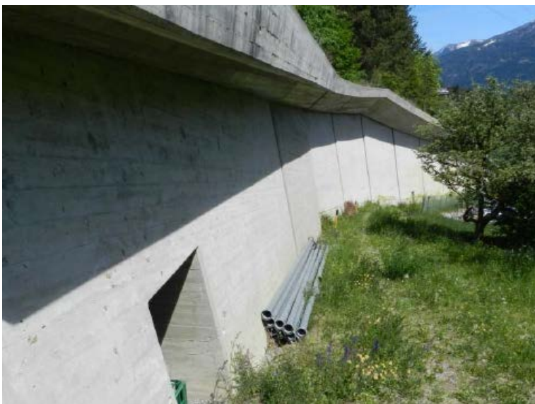
Abbildung 3 S16 Arlberg Schnellstraße, Stützmauer Gurnau
