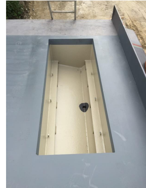
Tilgerkammer im Brückendeck
