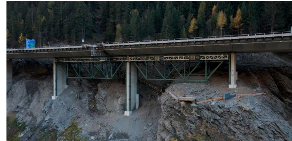
Luegbrücke (1968) – unterstellt, eingeschränkter Betrieb
